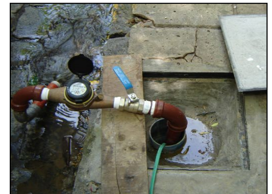
Punto de bombeo (B)
